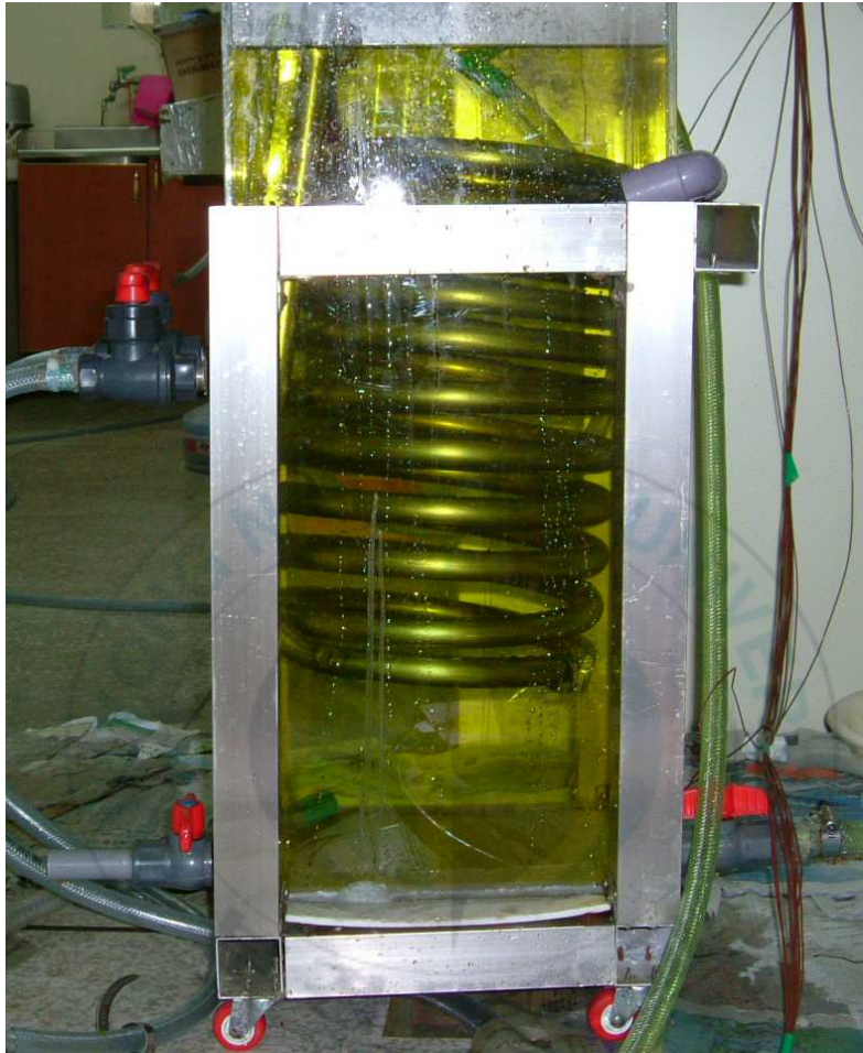
사진2.3. 티타늄열교환기가 설치된 저장탱크
