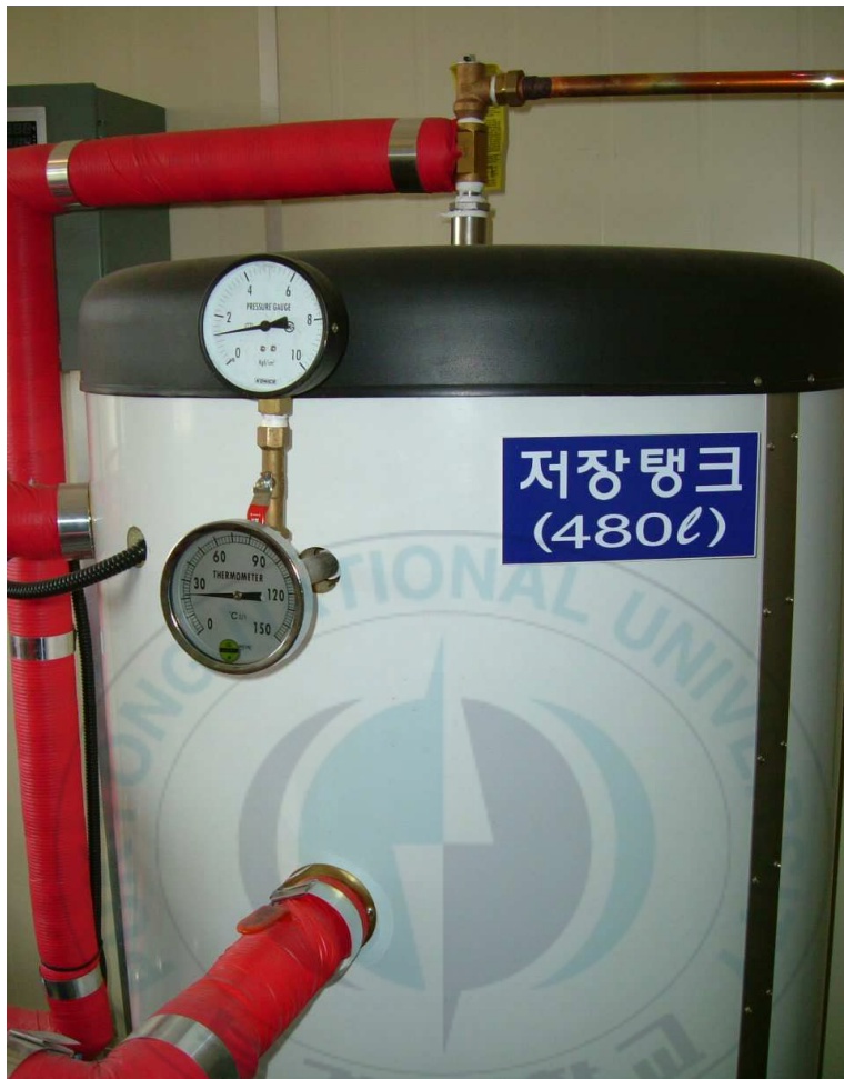
사진 2.2. 실내측 온수 저장탱크
