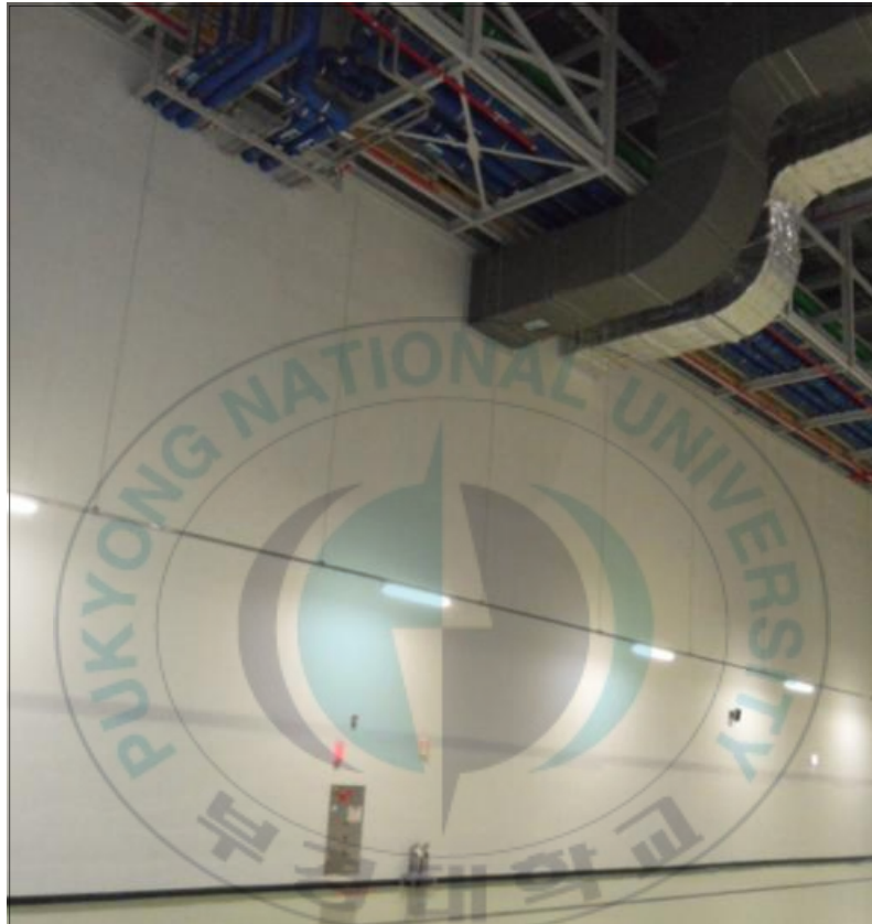
그림 1-2. 방화구획을 관통하는 수평덕트에 설치된 방화댐퍼 (설치높이 8m)
