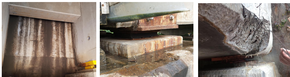
(a) 교대 오염 및 열화 (b) 받침부 열화 및 부식 (c) 상부구조 열화
