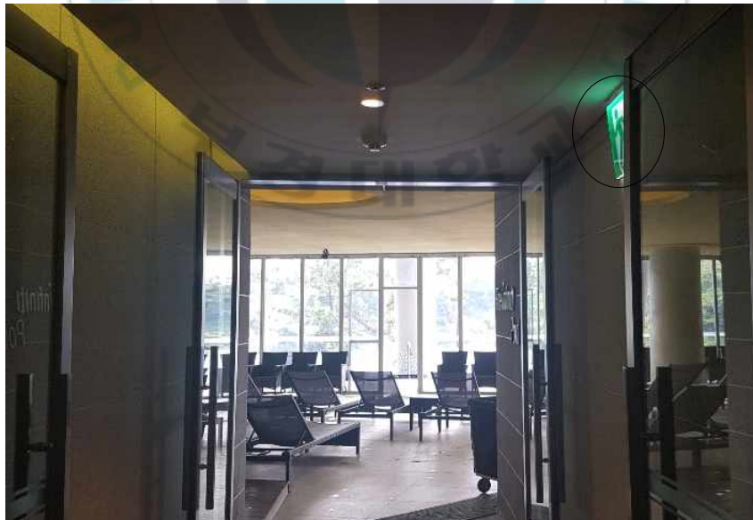
그림 1-2. 출입문 부근에 설치된 유도등
