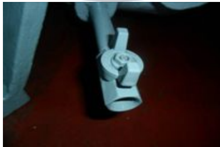
Fig. 3.21 Plugging 부적합 사례의 예시
