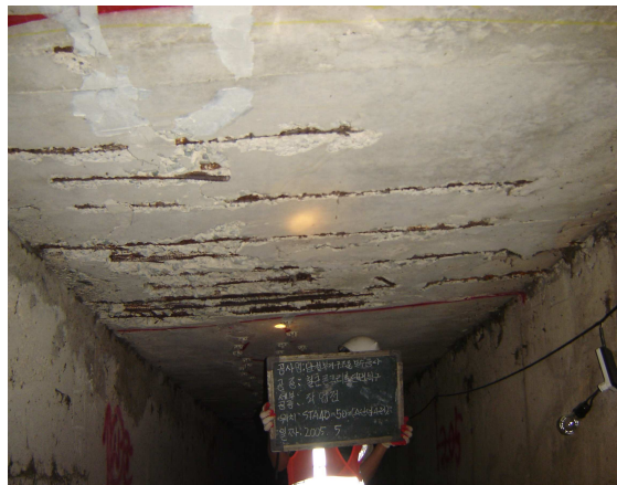
그림 1.1 철근 콘크리트 구조물의 노후화 현상
