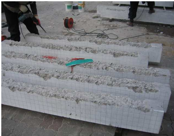
(a) 콘크리트 보의 하면 치핑 과정
