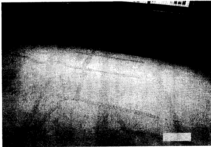
그림 4.15 노출양생 현장 균열발생 현황(b)
