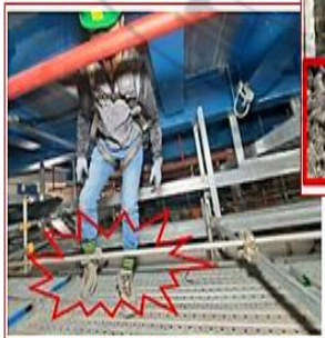
기 설치된 배관에 발이 걸려 넘어짐
