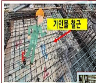
자재 정리 중 바닥 철근에 발걸려 넘어짐
